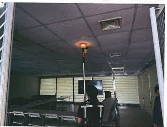
점검내용 화재감지기 동작 시험 점검장소 안산문화예술의전당 전시동
