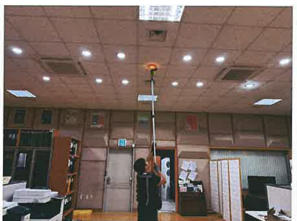
점검내용 화재감지기 동작 시험 점검장소 안산문화예술의전당 공연동
