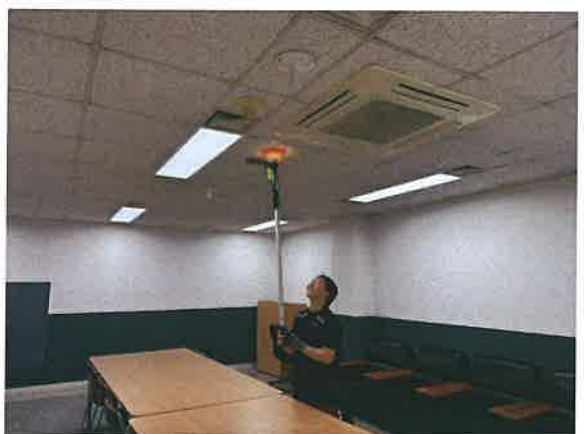
점검내용 화재감지기 동작 시험 점검장소 안산문화예술의전당 전시동
