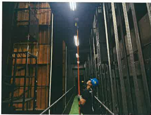
점검내용 화재감지기 동작 시험 점검장소 안산문화예술의전당 공연동
