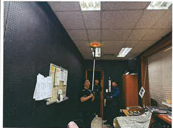
점검내용 화재감지기 동작 시험 점검장소 안산문화예술의전당 전시동
