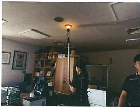
점검내용 화재감지기 동작 시험 점검장소 안산문화예술의전당 전시동
