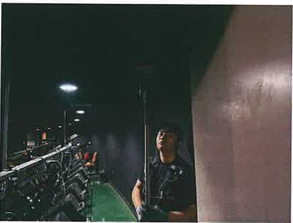
점검내용 화재감지기 동작 시험 점검장소 안산문화예술의전당 공연동
