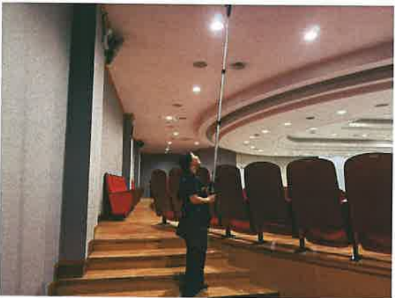
점검내용 화재감지기 동작 시험 점검장소 안산문화예술의전당 전시동
