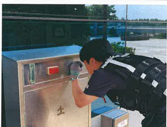
점검내용 옥외소화전함 기동표시등 점검 점검장소 안산문화예술의전당 공연동
