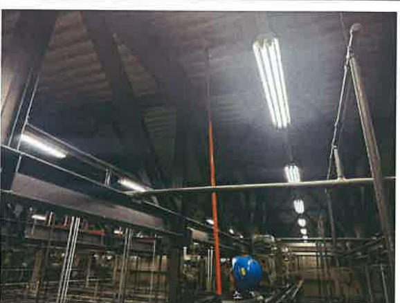
점검내용 화재감지기 동작 시험 점검장소 안산문화예술의전당 공연동
