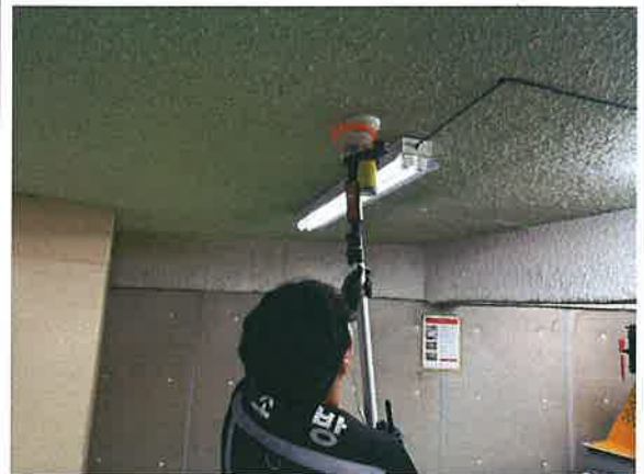
점검내용 화재감지기 동작 시험 점검장소 안산문화예술의전당 공연동
