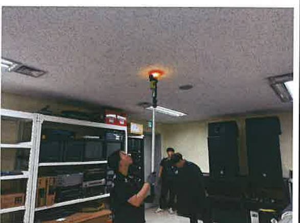
점검내용 화재감지기 동작 시험 점검장소 안산문화예술의전당 공연동
