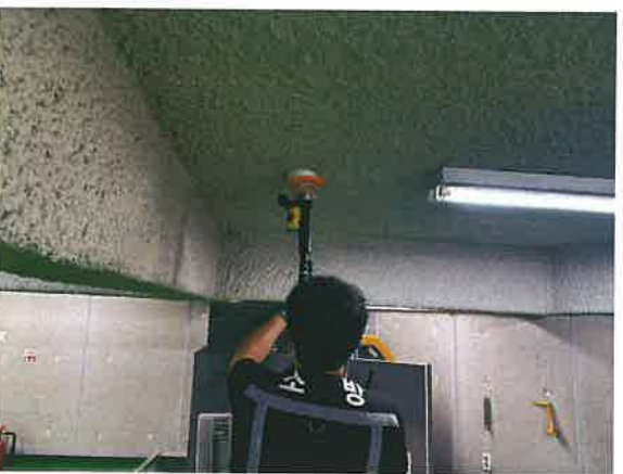
점검내용 화재감지기 동작 시험 점검장소 안산문화예술의전당 공연동
